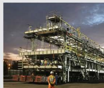
Piperack Modules (PAR)
