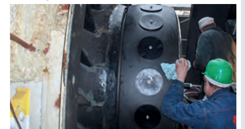
5 C-position booster fan
